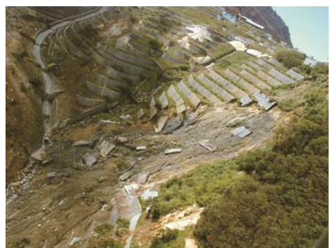
▲⑤ブロックの崩壊 (平成13年)
