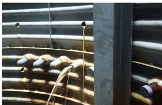
写真. 5 削孔泥水流出状況(集水井)
