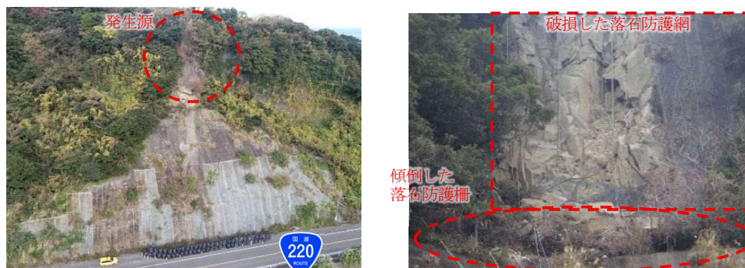
写真2 39.4kp 落石発生箇所(左:地震発生前、右:地震発生後) 1),2)
