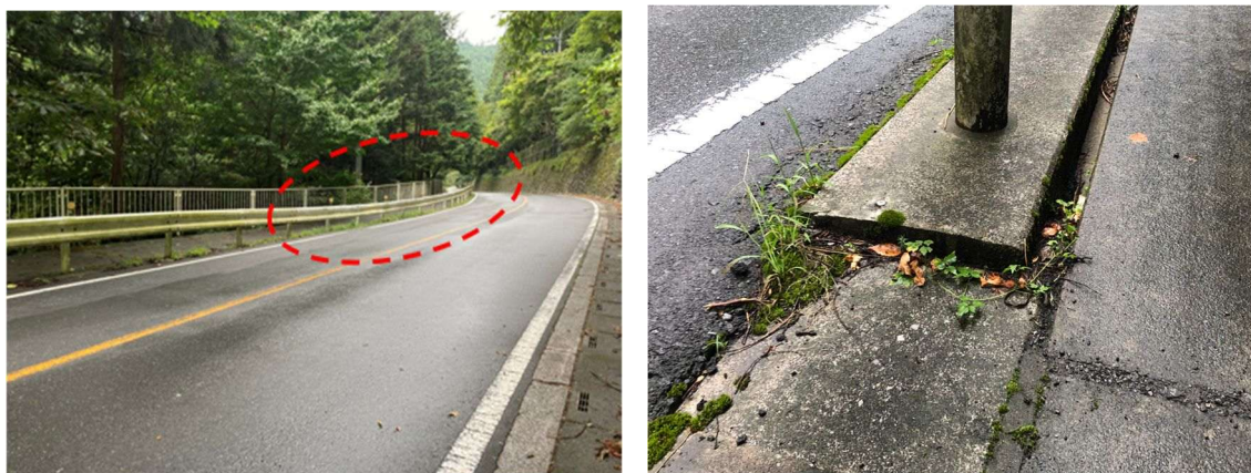
写真.1 箇所②の張出歩道周辺の沈下状況（左：全景，右：沈下部拡大）
