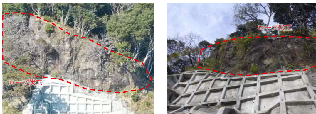
写真1 24.3kp 落石未発生箇所(左:地震発生前、右:地震発生後) 1),2)
