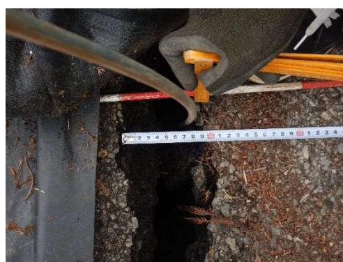
写真. 2 亀裂近接状況
