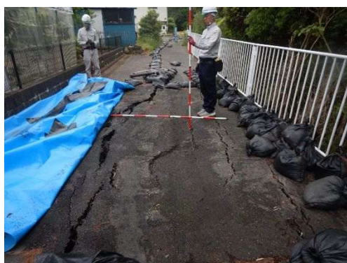
写真. 1 亀裂発生状況
