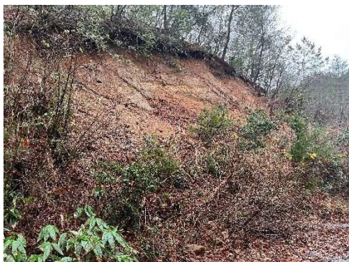
写真. 7 表層崩壊斜面
