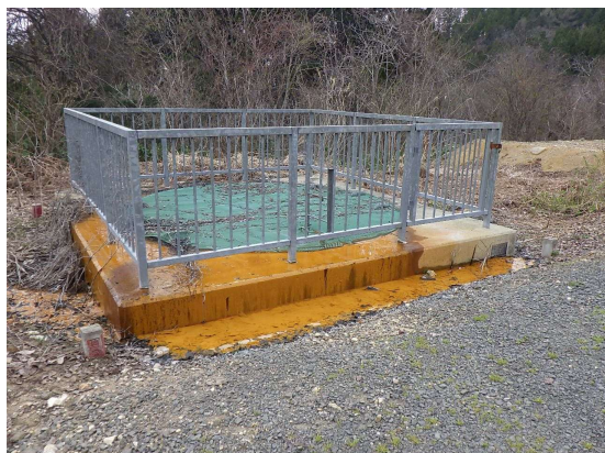
写真. 1a 集水井 W2 からの越流状況
