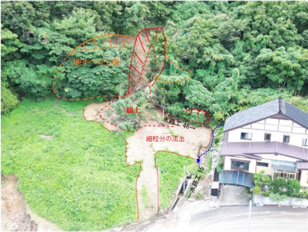
写真.1 被災箇所③の空撮写真 (発注者提供の写真に加筆)
