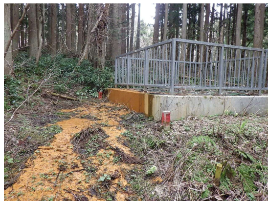
写真. 1b 集水井 W3 からの越流状況
