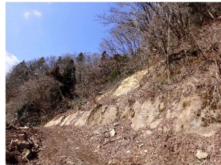
写真. 6 弱部が確認された斜面
