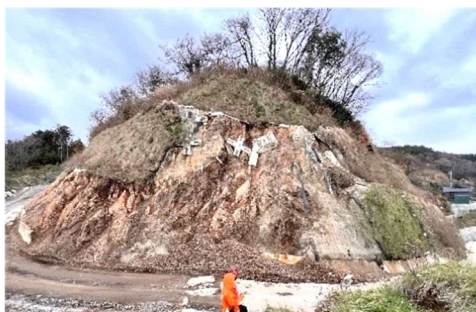
写真. 2 被災した法面保護工
