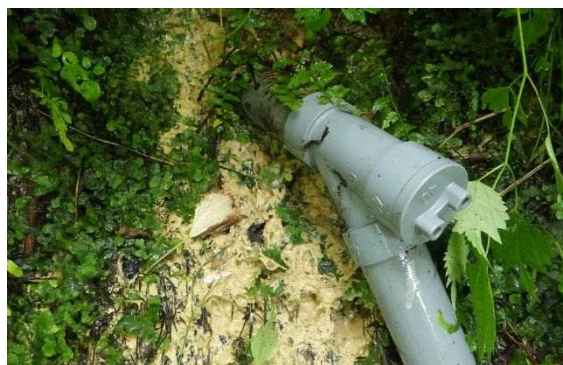
写真. 6 削孔泥水流出状況(地表)
