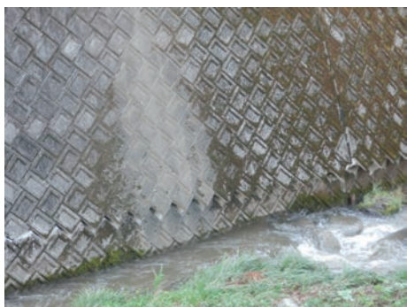
写真 11 河川護岸のはらみ
