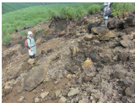
写真 50 滑落面の露出箇所
