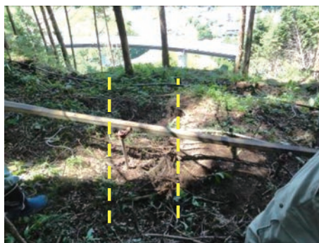
写真9 滑落崖に直交する亀裂
