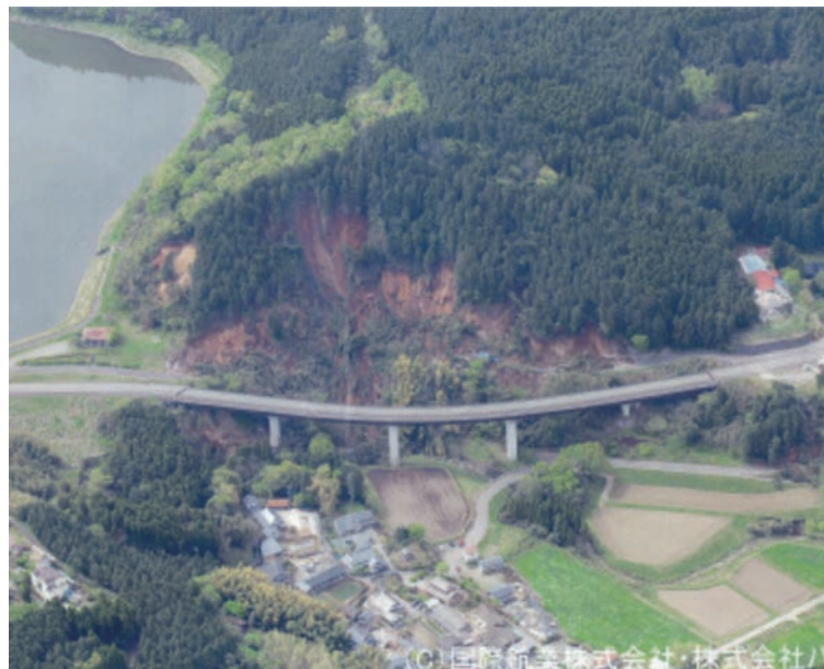
写真4 崩壊地全景（写真左が大切畑ダム貯水池） （国際航業，パスコ撮影）
