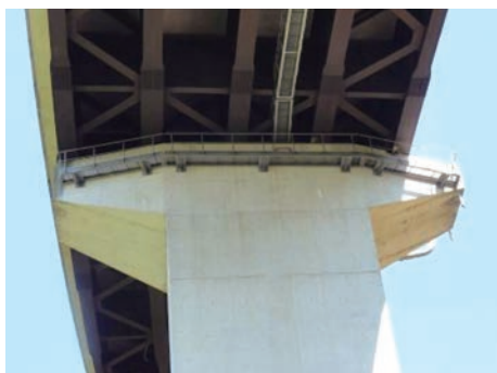
写真5 横ずれした大切畑大橋
