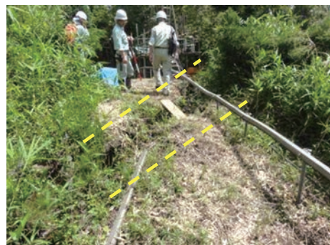
写真 43 Bブロック滑落崖背後の段差
