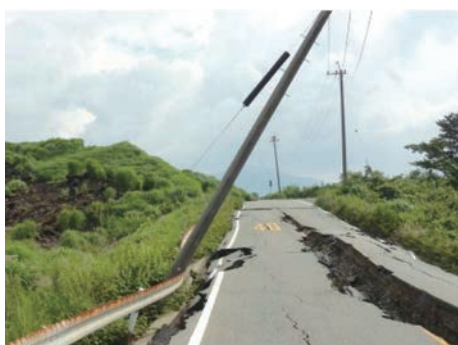
写真 52 地震で盛土が変形したことによると考えられる県道の路面変状
