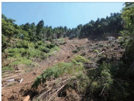
写真6 村道も巻き込んだ崩壊地中央部
