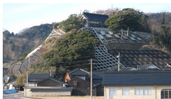
写真 6.5.3 平成 19 年度災害関連緊急地すべり対策事業完了後の全景 17)
