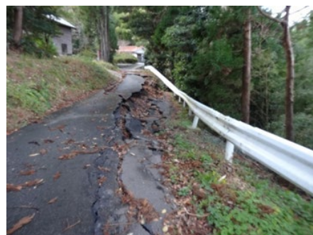
写真6.1.4 農道沿いの小規模滑落（水田ブロック群エリア）
