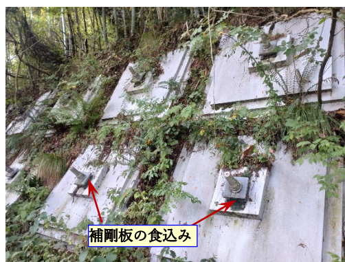
写真 6.6.4 アンカーの補剛板の食込み
