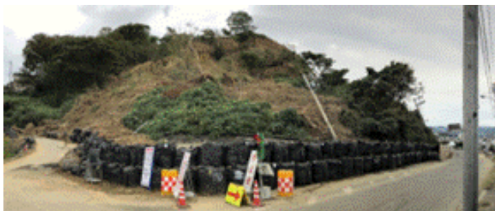
写真 5.2 国道 249 号沿いの海岸に面する急斜面での地すべり発生
