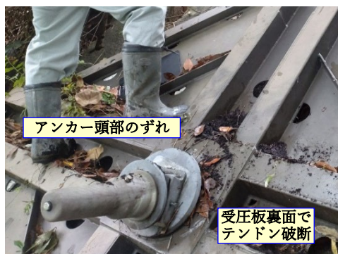
(a) アンカーと受圧板のずれ
