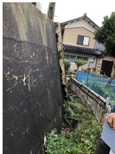
写真 6.3.4 赤神地区の擁壁工に見られる変位
