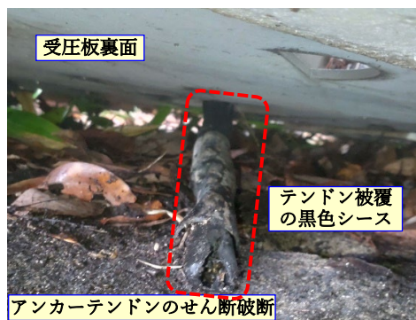
(b) 同受圧板の裏面状況
