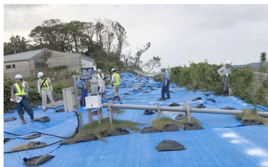
写真 6.2.2 大野地区の上部平坦面に生じた変状
