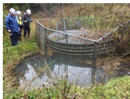
写真 6.10.2 地表まで湛水した集水井 (A-1 ブロック)
