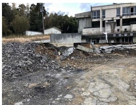
写真6.1.2 西方境界部にみられる段差亀裂（グラウンドブロック）
