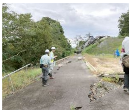
写真 6.5.2 鹿磯地区頭部の亀裂（奥に倒壊した神社の屋根が見える）
