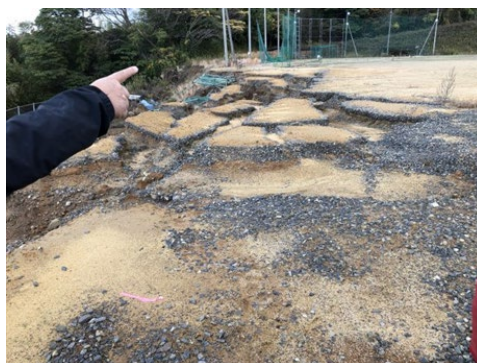
写真6.1.1 輪島高稲舟校の校庭北部にみられる亀甲状の亀裂（グラウンドブロック）
