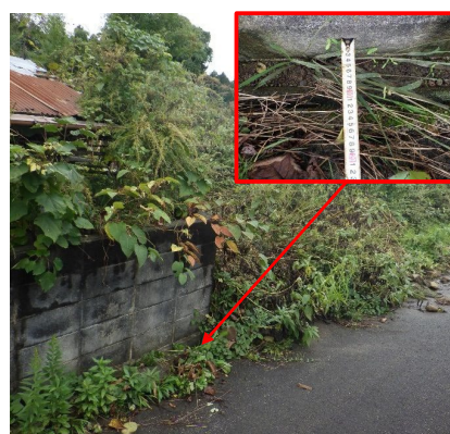
写真 6. 4. 1 末端部右側方部の擁壁と水路の変状
