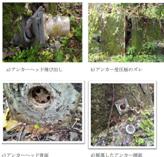
写真 6.10.1 アンカー頭部の損傷状況
