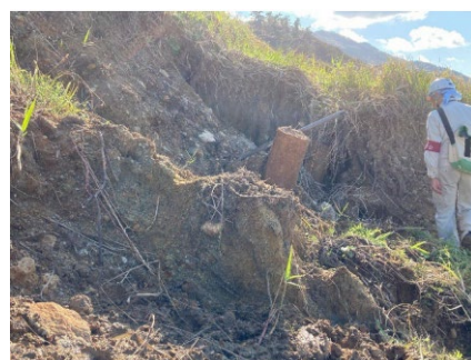
写真 6.9.4 海岸に面する地すべり地形末端部で生じた崩壊による鋼管杭の露出・傾倒
