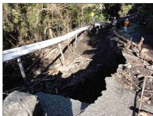
写真16 道路損壊箇所(その2)
