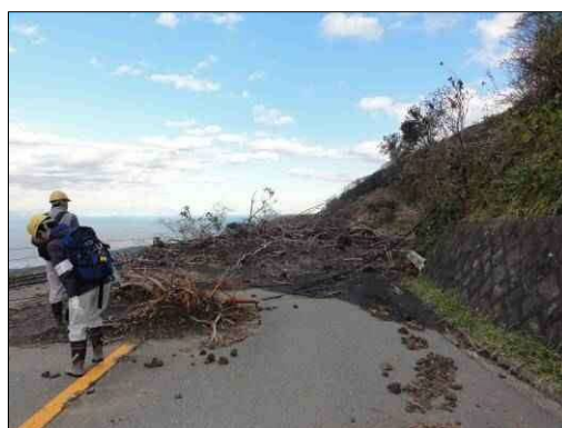
写真5 道路上の堆積土砂
