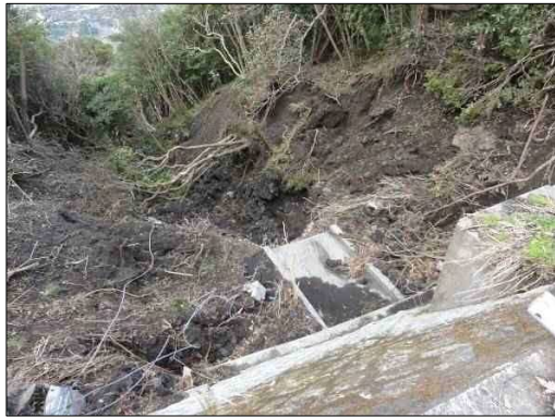
写真8 道路下の水路工の被災
