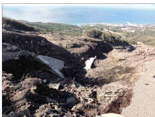
写真15 道路損壊箇所(その1) （写真右下で舗装面が切れている。）
