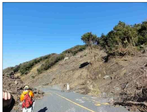
写真14 土砂流下経路上の道路 （土砂撤去後で損壊は見られない。）
